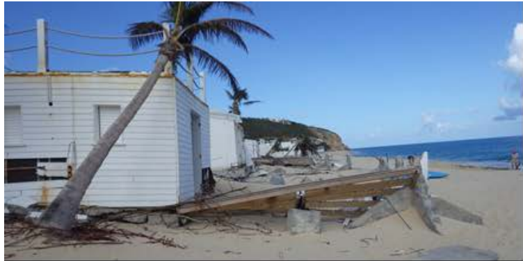
TC IRMA (2017) - SAINT-MARTIN - Baie Rouge (© V. Duvat)
